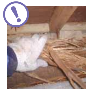
シロアリ被害にあった床下の様子
